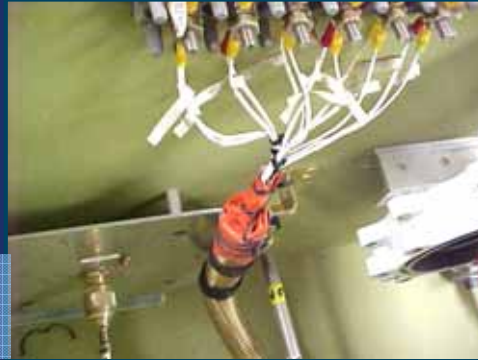
Acceptable conduit covering
